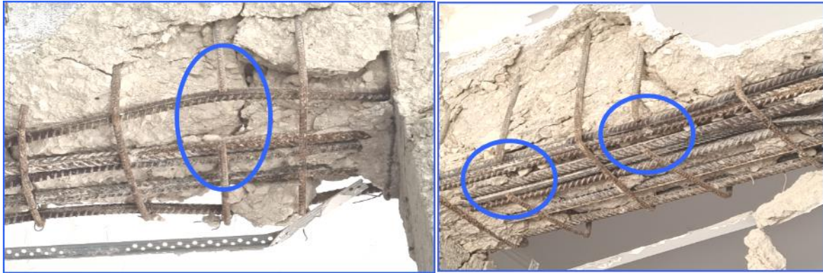
Şekil 1. Depremde kopan etriye hasarı
