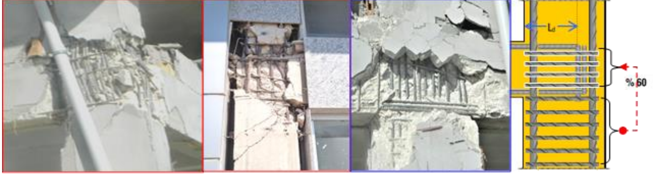
Şekil 9. Köşe ve kenar düğüm noktası deprem hasarları
