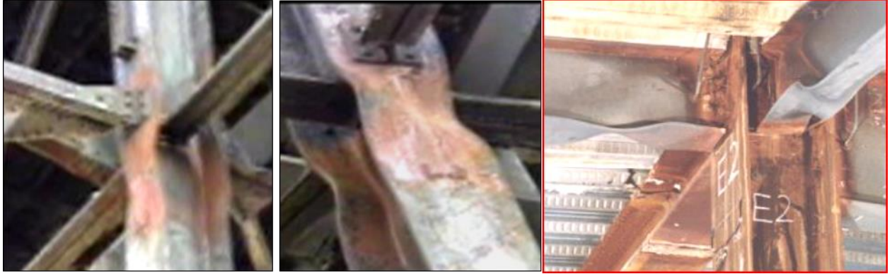
Şekil 4: Çelik çerçevelerde düğüm noktası deprem hasar örnekleri
