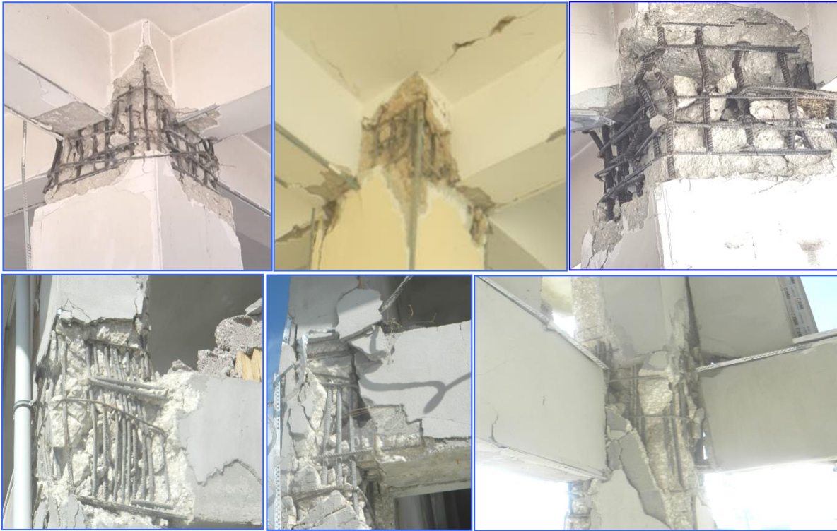
Şekil 3: Düğüm noktası deprem hasar örnekleri
