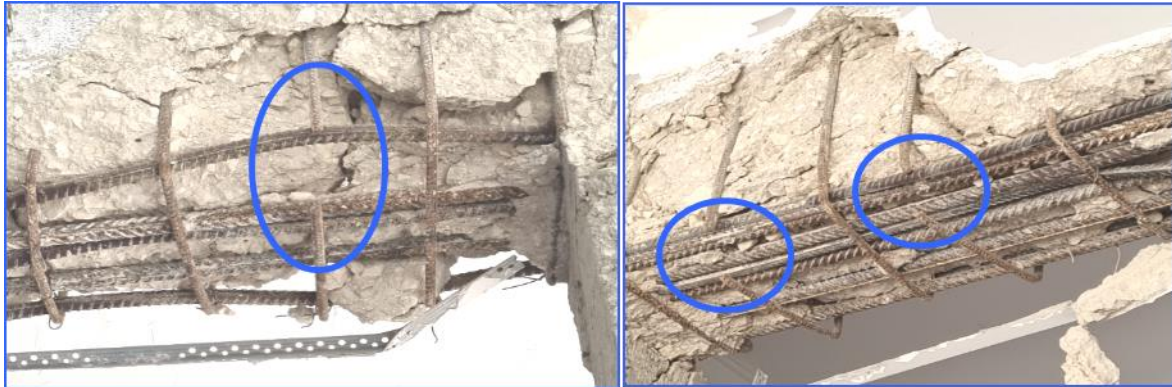
Şekil 1. Depremde kopan etriye hasarı
