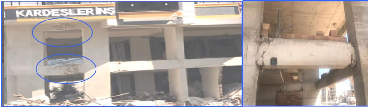
Şekil 2: Deprem kısa kiriş hasarları
