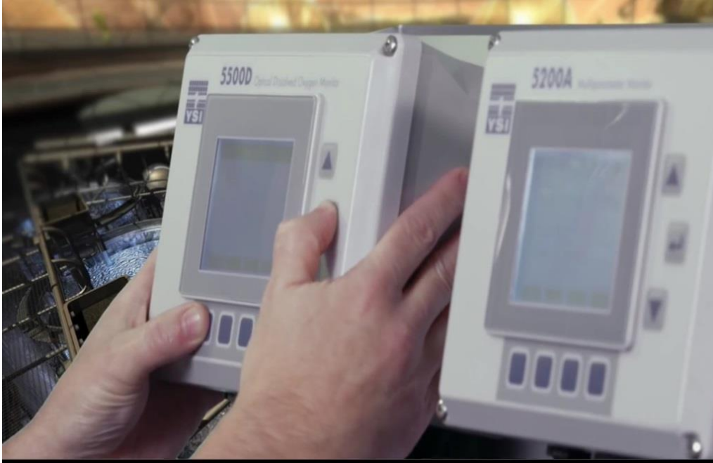
Şekil 5. Bir Üretim ünitesinde kontrol panelleri
